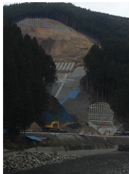
天川村深層崩壊災害復旧現場
